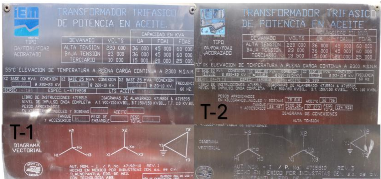
Figura 7. Placa de datos de los transformadores de potencia de la S.E. MOR [26].
